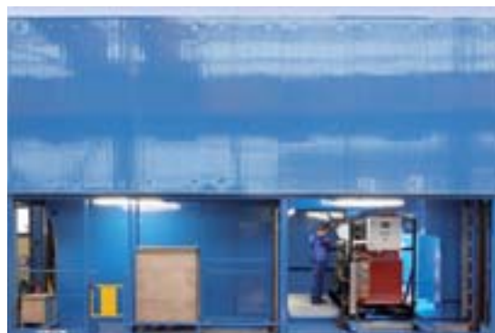
Pared lateral desmontable de la superestructura y generador Diesel montado sobre un carro
