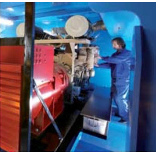
Unidad de generador Diesel montada sobre un carro que se puede extraer lateralmente
